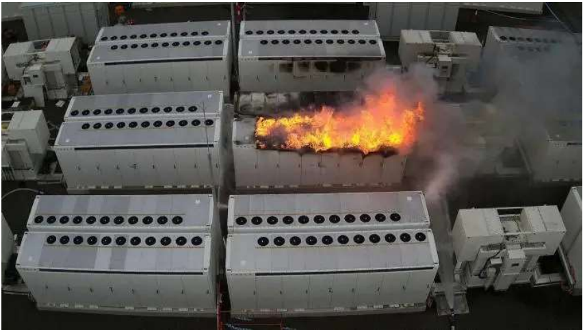
2021年08月，澳大利亞的Victorian Big Battery在測試期間發生火災事故，一個裝載13噸鋰離子電池的特斯拉 Megapack電池組起火燃燒。
