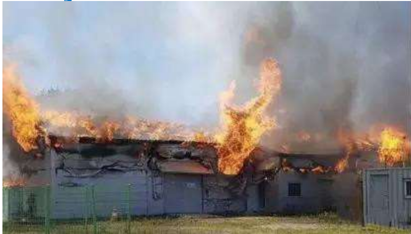
2019年9月，韓國風力發電站的電池儲能系統發生火災
